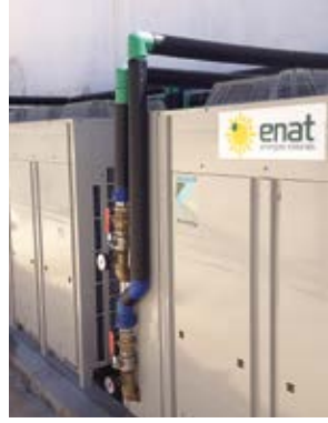
Chiller Piscina Vila Pouca de Aguiar
