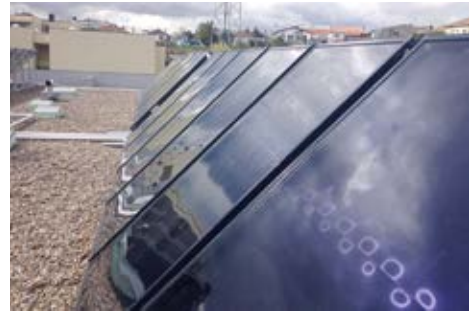
Solar Térmico AQS Santa Maria da Feira
