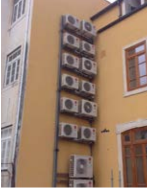
Ar Condicionado Coimbra
